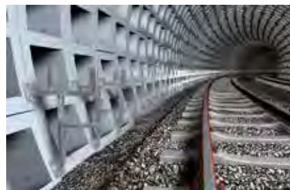
Installazioni in galleria
