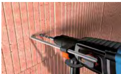
Fori su muratura
