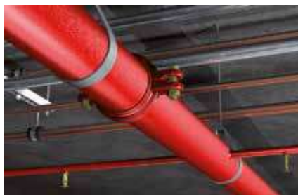
Impianti antincendio Sprinkler
