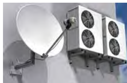
Antenne paraboliche e condizionatori
