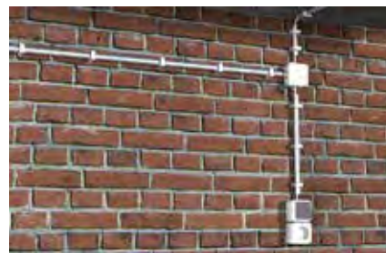
Fissaggio di cavi
