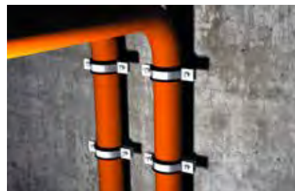
Fissaggio delle condotte in plastica
